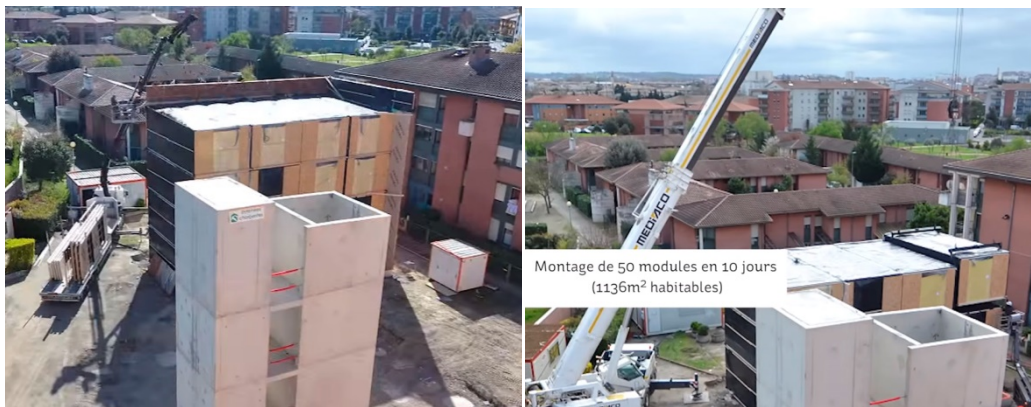
Figura 8. Processo de montagem in loco com o uso de guias. Fonte: ADOMA, 2015.
