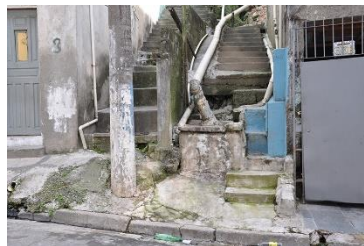
Figura 18: Estado atual das escadarias. Fonte: H+F Arquitetos
