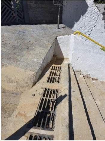
Figura 6: Boca de Lobo no topo da escadaria Chico Science. Foto: André Marques
