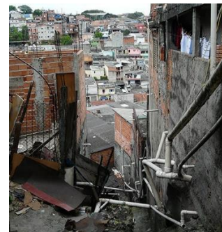
Figura 19: Estado atual das escadarias. Fonte: H+F Arquitetos
