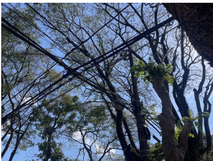
Figura 11 - Copas das árvores interseccionando com cabos de energia e comunicação na Rua Pirandello
