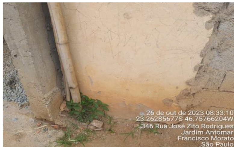
Figura 8 - Marcas de inundação em moradia no Bairro do Rosário.
