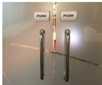
Figura 3: Exemplo de porta com maçaneta inadequada e mensagem indicativa de sentido de abertura.
