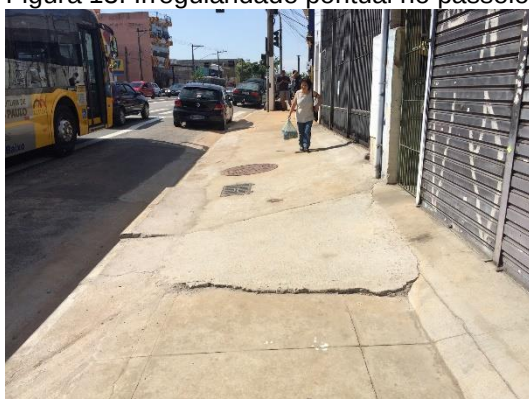
Figura 13. Irregularidade pontual no passeio:
