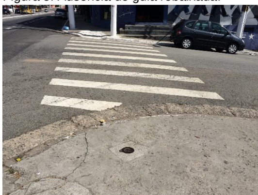
Figura 5. Ausência de guia rebaixada:
