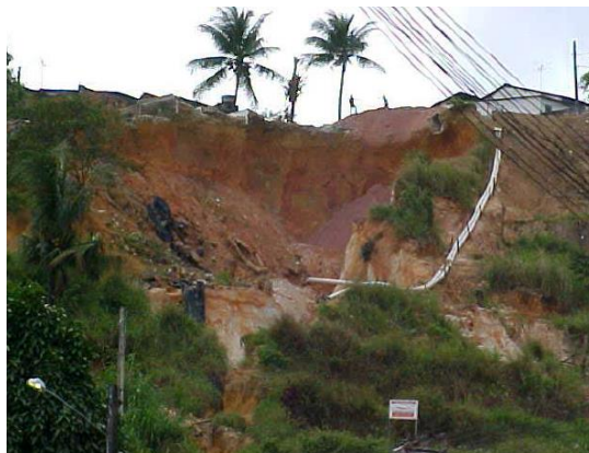
Figura 1 – Erosão na Rua Camanducaia, Ibura, Recife Bandeira (2010)
