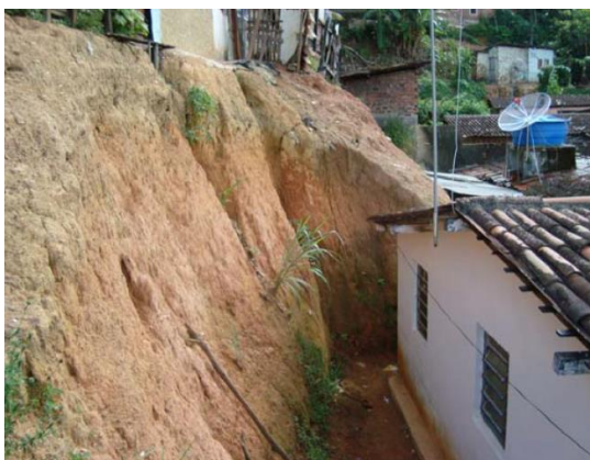
Figura 3 – Taludes Verticalizados e sem proteção superficial – Encostas da RM-Recife BANDEIRA (2010)
