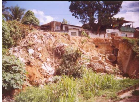
Figura 2 – Erosão em Camaragibe – área urbana de Recife BANDEIRA (2010)
