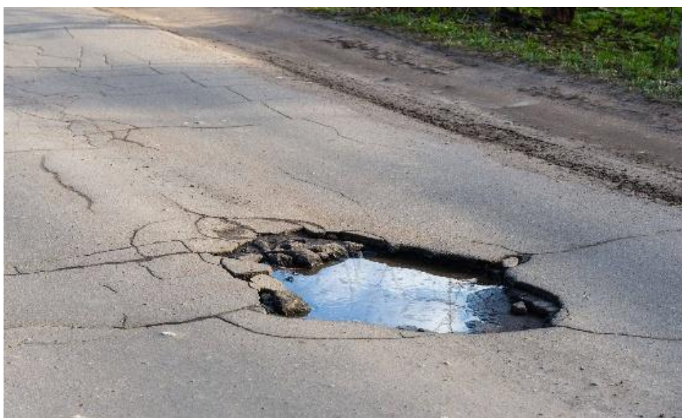
Figura 1 – Buraco em Pavimento.
