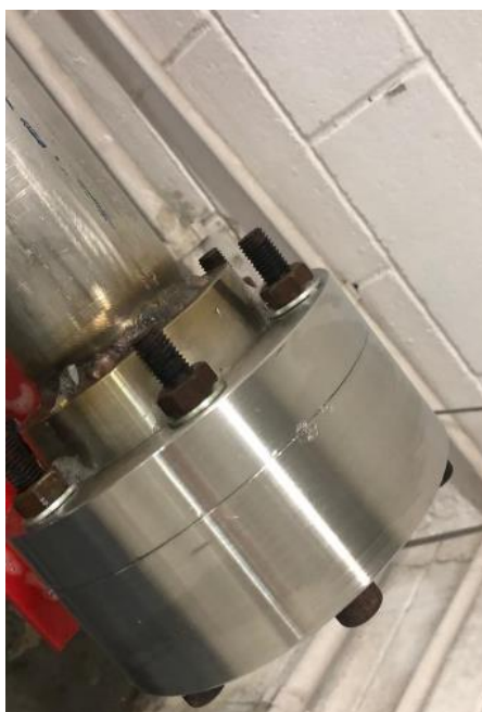
Imagem 9 - Vazamento de gás percebido pela formação de bolhas.
