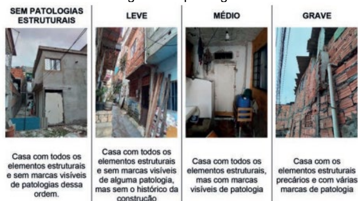
Figura 2 – Levantamentos referentes aos graus de patologias nas Estruturas
