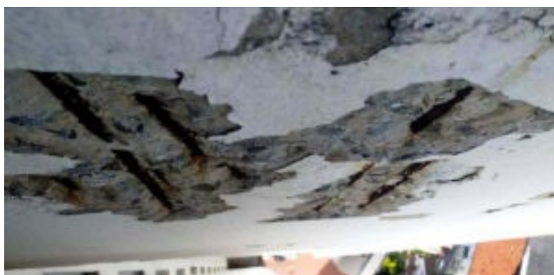
Figura 1- Corrosão de armaduras está entre as manifestações patológicas mais preocupantes em uma obra.
