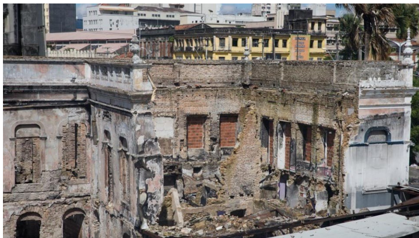
Figura 2- O Casarão dos Fabricantes, no Centro, estava tombado provisoriamente e sofreu um incêndio em 2020
