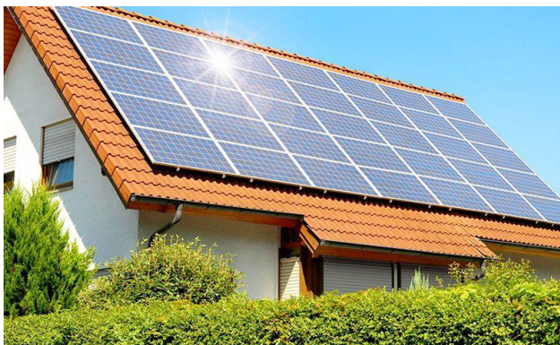
Figura 1: Paine solar fotovoltaico em casa
