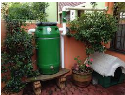
Figura 3: Cisterna coletora de água em casa
